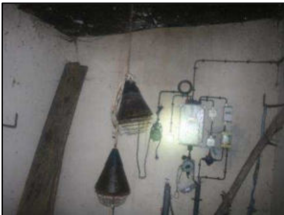
Foto 57: Blick in das Innere von Gebäude 9 (Pumpenhaus)
