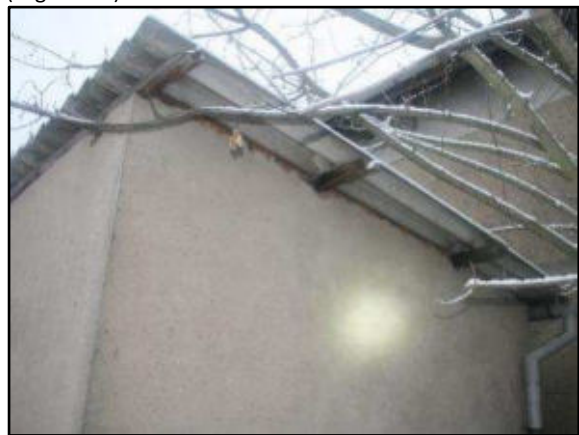
Foto 10: südwestliche Dachseite mit Einschupfmöglichkeiten für Fledermäuse zwischen Maueroberkante und Asbestverdachung am Waagehaus (Gebäude 2)
