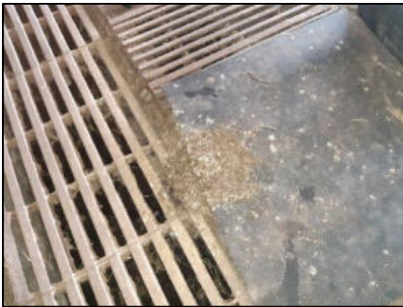
Foto 12: Kotablagerung unterhalb eines 2023 benutzten Rauchschnalbennests im südlichen Stall (22.06.2023)
