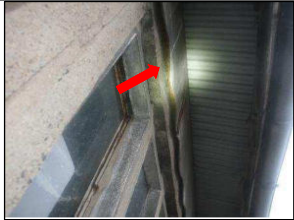
Foto 32: mögliches Fledermausspaltenquartier hinter abstehender Fassadenverkleidung oberhalb der Befensterung (roter Pfeil) an der Südwestseite des Gebäudes 4 (Stall)
