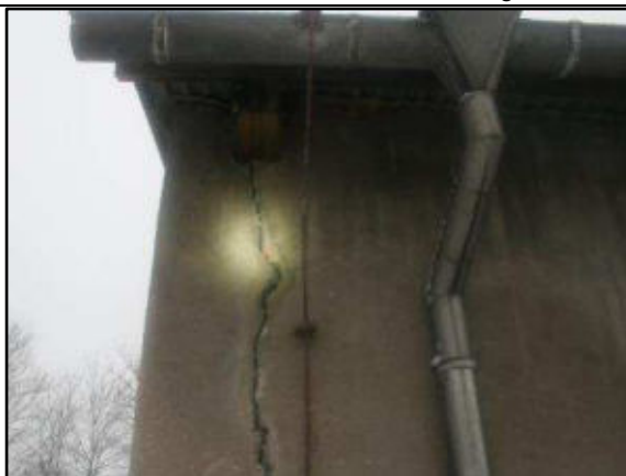
Foto 14: potentielles Spaltenquartier Fledermäuse (Mauerriss) nahe der nordöstlichen Gebäudeecke an Gebäude 3 (Stall)
