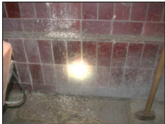
Foto 22: Kotablagerungen unterhalb eines Rauchschwalbennestes im Inneren des Gebäudes 3 (Stall)
