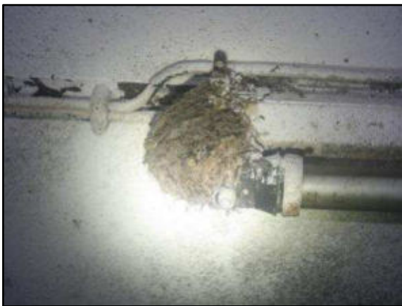
Foto 21: Nest einer Rauchschwalbe an einer Leuchte im Inneren des Gebäudes 3 (Stall)
