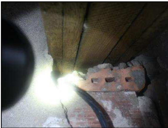
Foto 15: hohlraumbietender Mauerausbruch (potentielles Fledermausquartier) an Außenwand unterhalb Dachauflage nahe Nordwestecke des Gebäudes 3 (Stall)
