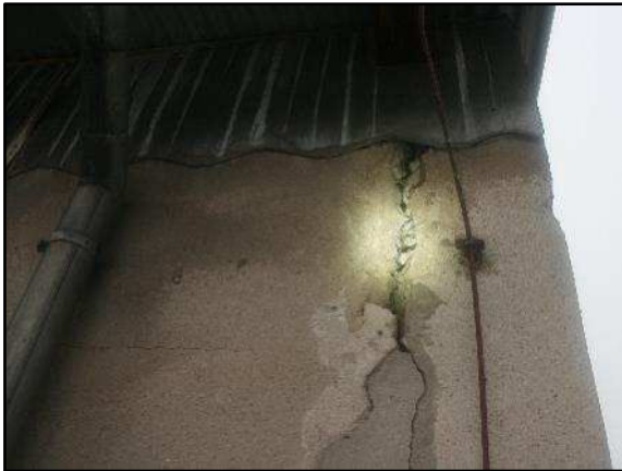
Foto 33: potentielles Spaltenquartier Fledermäuse (Mauerriss) nahe der südöstlichen Gebäudeecke an Gebäude 4 (Stall)
