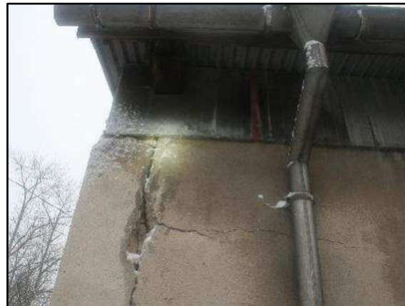
Foto 30: potentielles Spaltenquartier Fledermäuse (Mauerriss) nahe der nordöstlichen Gebäudeecke an Gebäude 4 (Stall)
