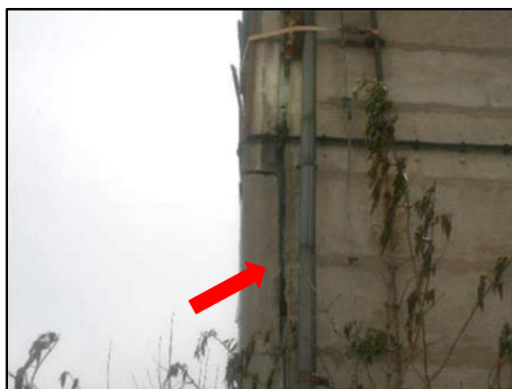
Foto 5: potentielles Spaltenquartier Fledermäuse (Mörtelausbruch) nahe der südöstlichen Gebäudeecke (roter Pfeil) an Gebäude 1 (Lagerhalle)
