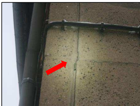
Foto 4: potentielles Spaltenquartier Fledermäuse (Mörtelausbruch) nahe der nordöstlichen Gebäudeecke (roter Pfeil) an Gebäude 1 (Lagerhalle)
