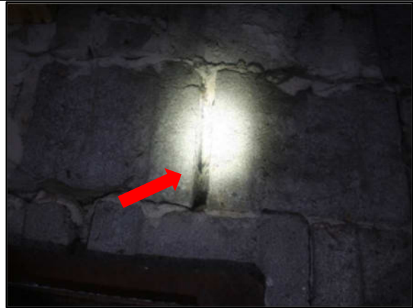
Foto 50: potentielles Spaltenquartier in Mörtelfehlstelle (roter Pfeil) an nordöstlicher Außenmauer von Gebäude 8 (Entenstall)
