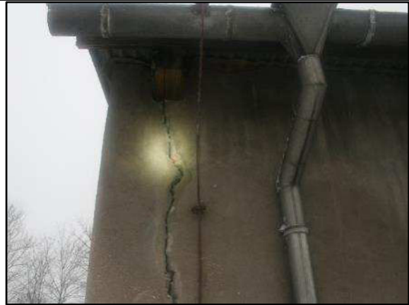
Foto 14: potentielles Spaltenquartier Fledermäuse (Mauerriss) nahe der nordöstlichen Gebäudeecke an Gebäude 3 (Stall)
