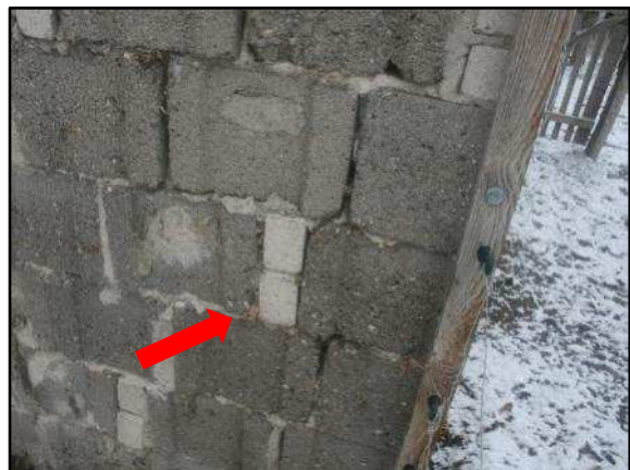
Foto 54: Reste eines Hornissennests (roter Pfeil) in südwestlicher Außenmauer von Gebäude 8 (Entenstall)
