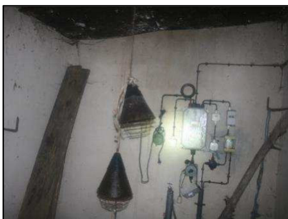
Foto 57: Blick in das Innere von Gebäude 9 (Pumpenhaus)
