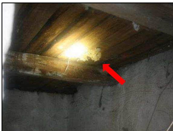
Foto 59: Reste eines Hornissennests an der Innendecke von Gebäude 10 (Wasserhäuschen)
