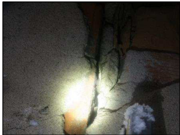
Foto 16: potentielles Spaltenquartier Fledermäuse (Mauerriss) nahe der südwestlichen Gebäudeecke an Gebäude 3 (Stall)
