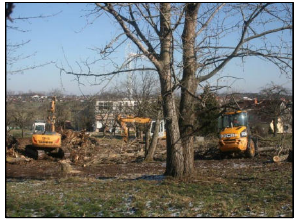
Foto 2: weitgehend entfernter Balsam-Pappelbestand östlich der Stallungen
