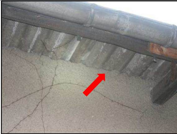
Foto 43: Einschupfmöglichkeit für Fledermäuse zwischen oberem Wandabschluss und Dachauflage (roter Pfeil) an der Südwestseite von Gebäude 6 (Wohnhaus)
