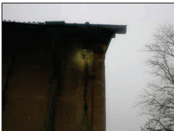
Foto 17: potentielles Spaltenquartier Fledermäuse (Mauerriss) nahe der südöstlichen Gebäudeecke an Gebäude 3 (Stall)
