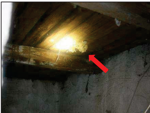
Foto 59: Reste eines Hornissenests an der Innendecke von Gebäude 10 (Wasserhäuschen)
