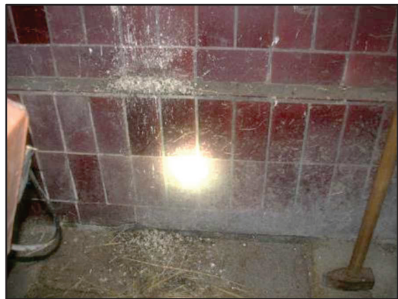
Foto 22: Kotablagerungen unterhalb eines Rauchschnalbenestes im Inneren des Gebäudes 3 (Stall)
