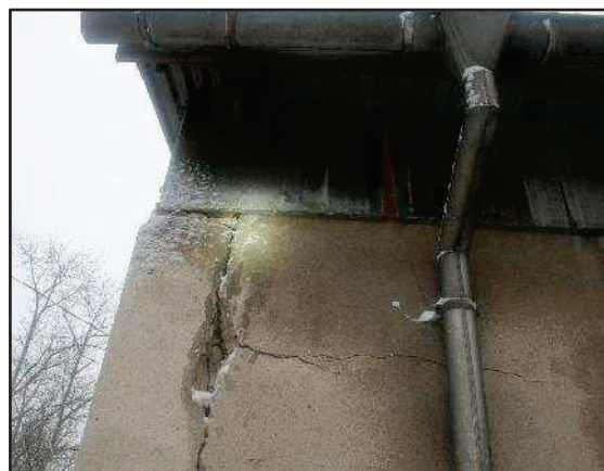
Foto 30: potentielles Spaltenquartier Fledermäuse (Mauerriss) nahe der nordöstlichen Gebäudeecke an Gebäude 4 (Stall)
