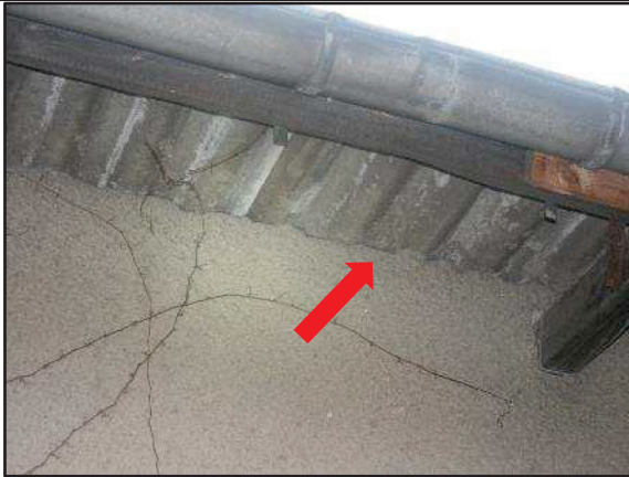
Foto 43: Einschlußmöglichkeit für Fledermäuse zwischen oberem Wandabschluss und Dachauflage (roter Pfeil) an der Südwestseite von Gebäude 6 (Wohnhaus)
