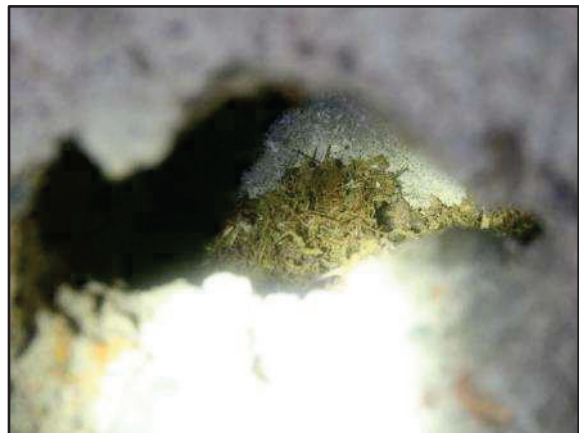
Foto 52: Nest einer Meisen in einem Hohlblockstein in nordöstlicher Außenmauer von Gebäude 8 (Entenstall)
