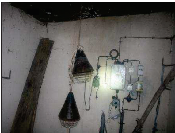
Foto 57: Blick in das Innere von Gebäude 9 (Pumpenhaus)
