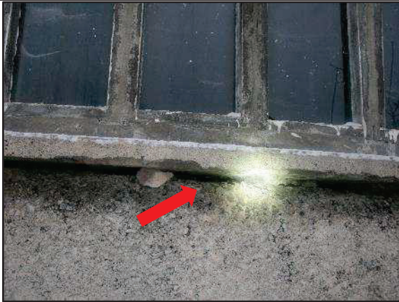
Foto 31: roter Pfeil markiert waagerechten Hohlraum unter Fensterbank (potentielles Spaltenquartier Fledermäuse) an Nordostseite des Gebäudes 4 (Stall)
