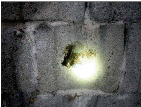
Foto 53: Nest einer Meisen in einem Hohlblockstein in südwestlicher Außenmauer von Gebäude 8 (Entenstall)
