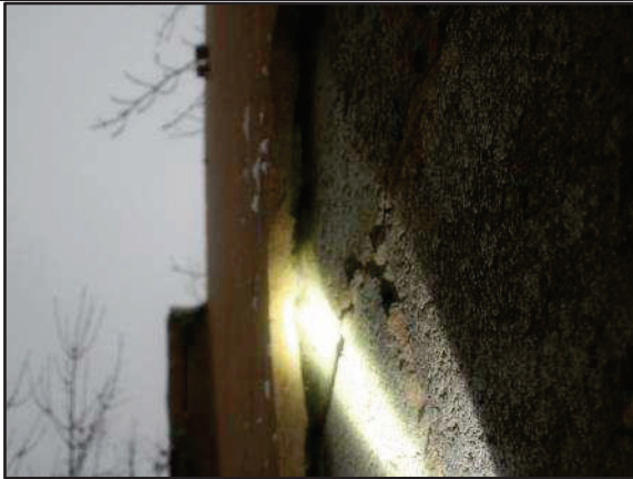
Foto 61: Hohlraum hinter abstehendem Putz an Südostseite von Gebäude 11 (Restmauer)
