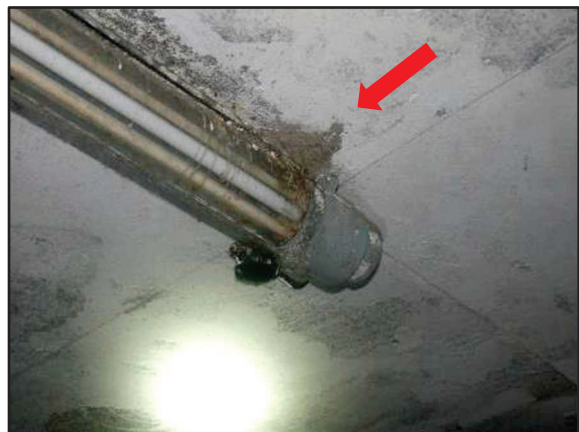
Foto 36: Rest eines Rauchschnalbenestes an einer Deckenleuchte im Gebäude 4 (Stall)
