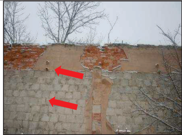
Foto 62: beispielhafte potentielle Fledermausquartiere in Lüftungsrohren (oberer roter Pfeil) und in Mörtelausbrüchen (unterer roter Pfeil) an der Südostseite von Gebäude 11 (Restmauer)
