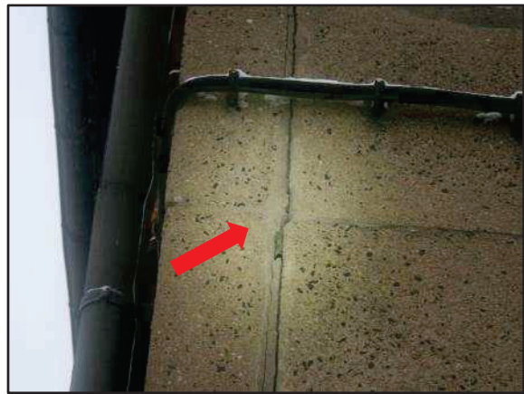
Foto 4: potentielles Spaltenquartier Fledermäuse (Mörtelausbruch) nahe der nordöstlichen Gebäudeecke (roter Pfeil) an Gebäude 1 (Lagerhalle)
